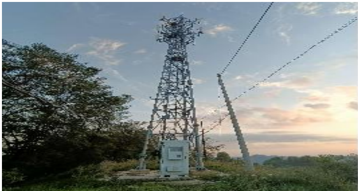
中国移动黑龙江智慧钠电项目 · 应用场景：通信基站 · 项目地点：黑龙江 黑河
