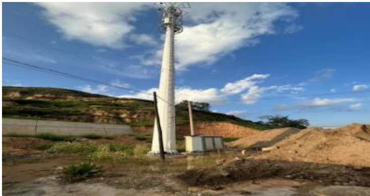
中国铁塔甘肃智慧钠电项目 · 应用场景：通信基站 · 项目地点：甘肃 天水
