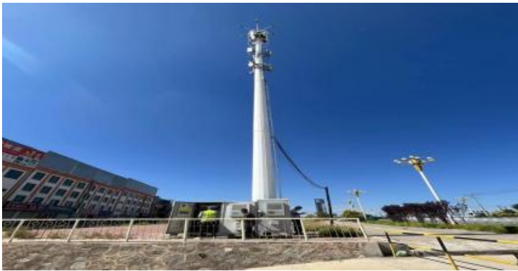
中国铁塔甘肃智慧钠电项目 · 应用场景：通信基站 · 项目地点：甘肃 白银
