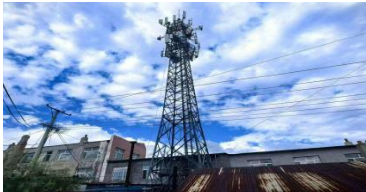
中国铁塔辽宁智慧钠电项目 · 应用场景：通信基站 · 项目地点：辽宁
