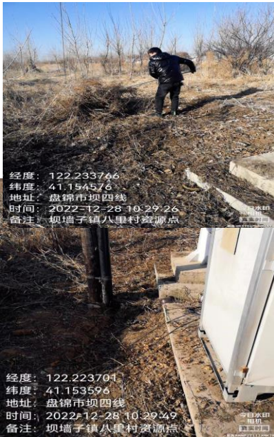
远程发现隐患派单一线代维人员现场处理隐患
