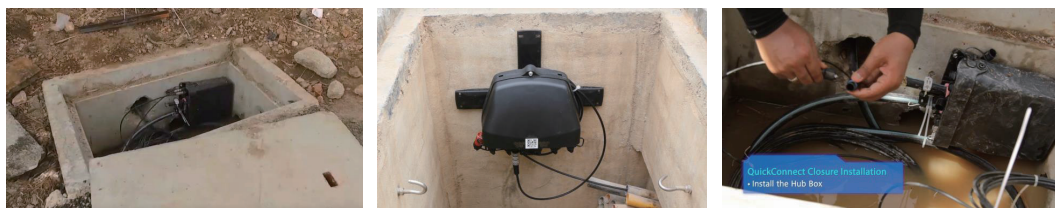
❗ 图 5-7 室外管道应用场景 ❗
